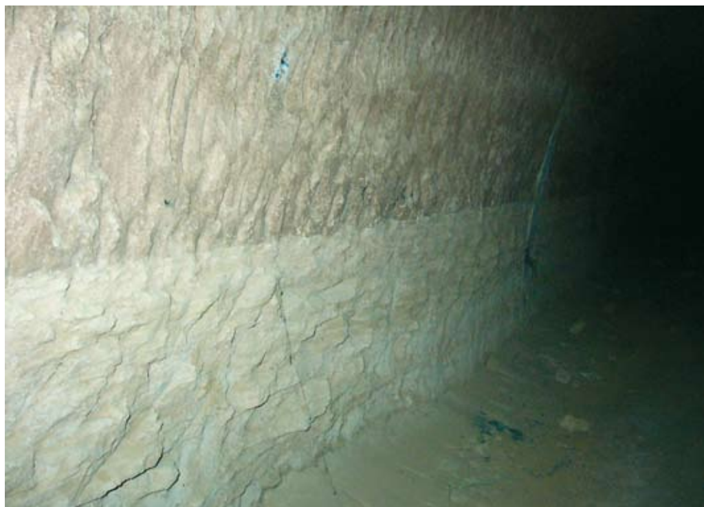
Marca del agua en el interior del túnel.
